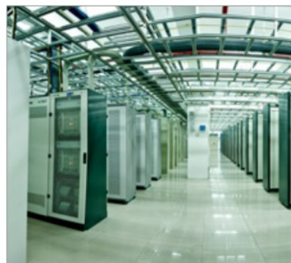
吉林移动数据中心 Mobile Data Center in Jilin 地点(Place): 吉林 Jilin 面积(Area): 10400m 2 地板类型(Panel Type): 硫酸钙地板
