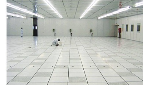
Communication center 通讯中心
